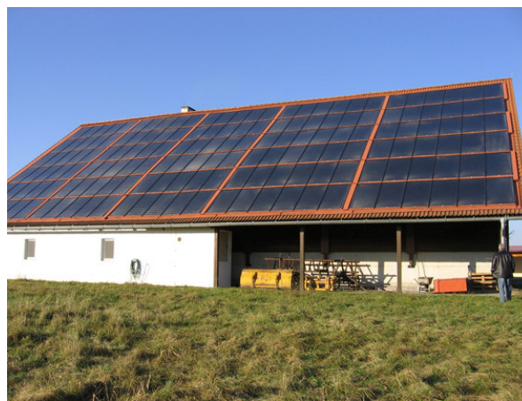
Zdj.2. Instalacja fotowoltaiczna
